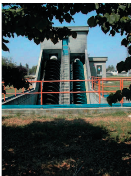
Figura 5: Depuratore: fase di sollevamento, punto più critico per la produzione di aerosol.
