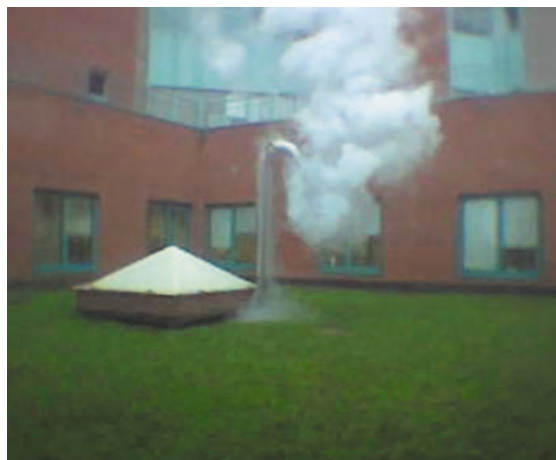
Fotografie dell'espulsione dell'elio gassoso attraverso il condotto di sicurezza, eseguite con un cellulare subito dopo l'evento.
