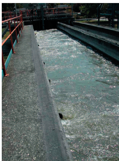
Figura 4: liquami in entrata al depuratore
